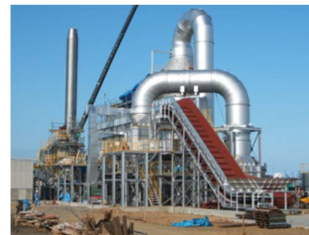
(仙台市設置仮設焼却炉)
