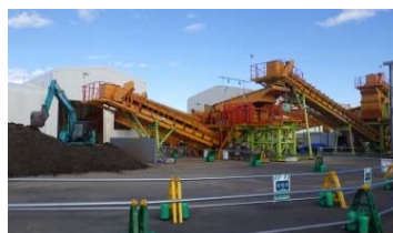
檜葉町の仮置場内破碎選別設備
