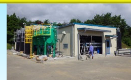
排水処理設備の管理
