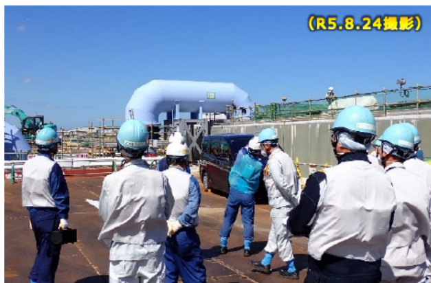
県安全確保技術検討会による監視 (放水関連設備)
