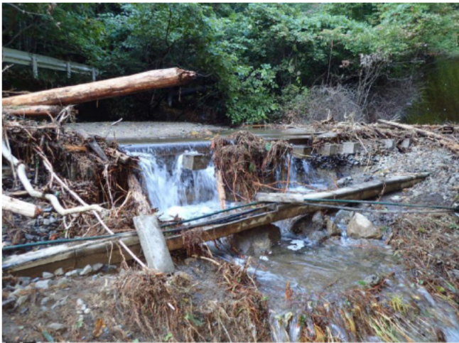
土砂流入、道床流失（普代～白井海岸）
