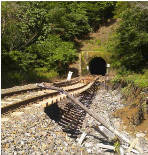
路盤・道床流出（両石～釜石）
