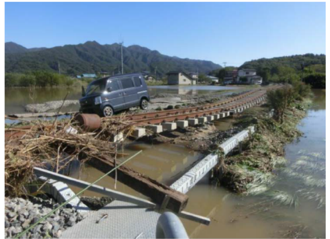
路盤・道床流出（津軽石～弘川）
