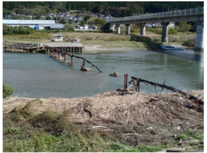
サケ採捕施設の破損 (大船渡市)
