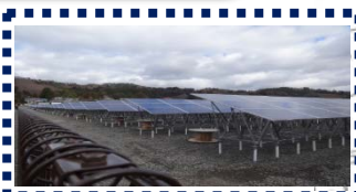
太陽光発電施設(写真)
