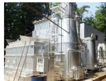
【バイオマスボイラ】
