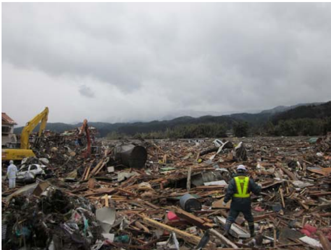
津波により災害を受けた岩手県陸前高田市
