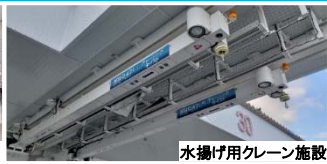
水揚げ用クレーン施設
