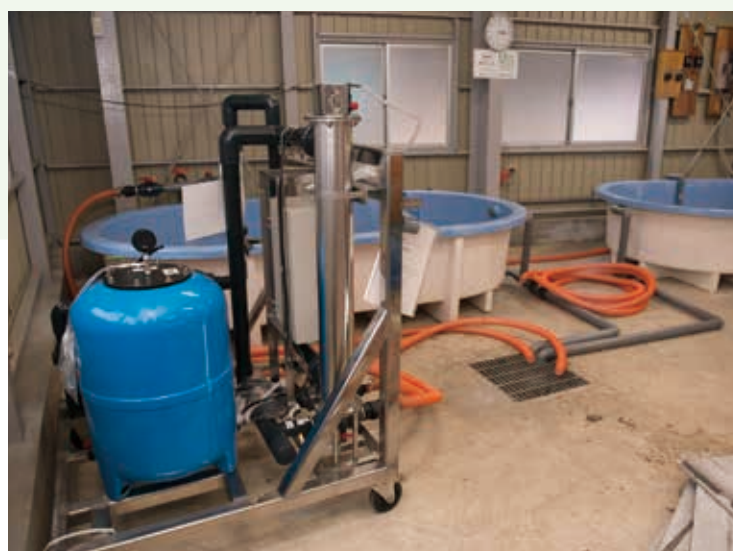
ヤリイカの畜養に必要な設備は、「復興応援 キリン絆プロジェクト」の助成金を活用して整備。加工工場には2つの生け簀をはじめ、海水の滅菌装置、砂ろ過装置などがある。
