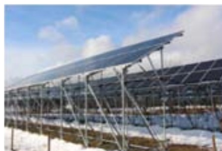
30度の急傾斜で地面から2.5メートルの高さに設置された太陽光パネル
