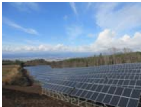
雄国地域の太陽光発電設備
