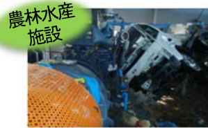
八沢排水機場（相馬市）
