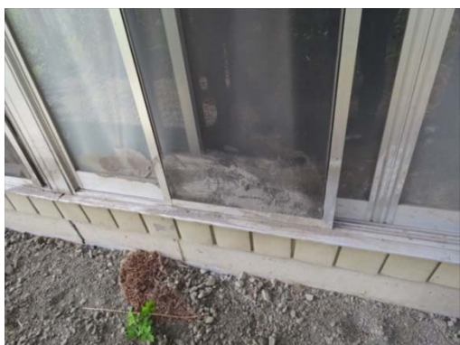
住宅の窓へ付着した泥
