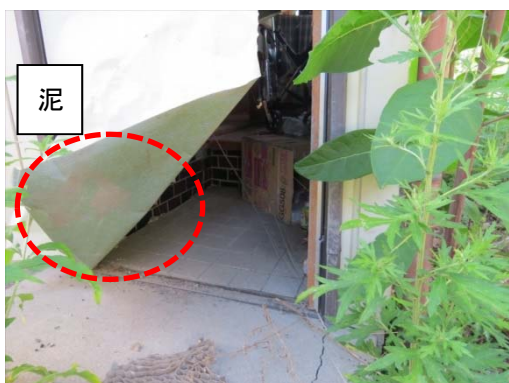
住宅へ侵入した痕跡
