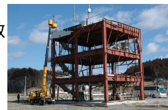
← 南三陸町防災対策庁舎
