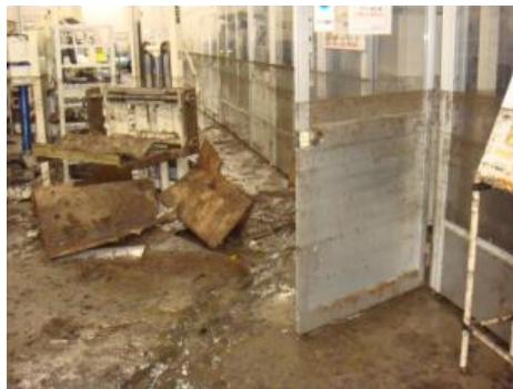
建屋内(泥が堆積)
