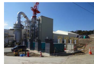
葛尾村の仮設焼却施設 (平成27年4月)
