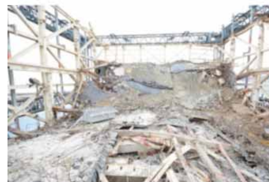
1号機建屋上部のガレキの状況
