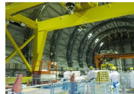
クレーンと燃料取扱機
