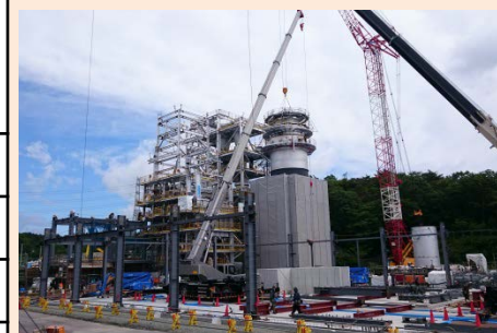
楢葉町の仮設焼却施設 （平成28年6月）
