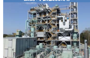
広野町仮設焼却炉
