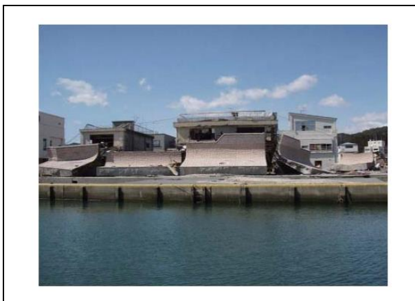
図表 5-13-2 倒壊した防潮堤 (岩手県山田町)
