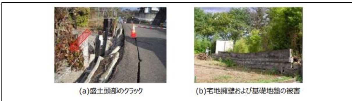
図表 5-4-2 盛土全体の変形被害が発生した地区の被害写真
