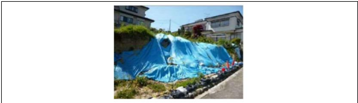
図表 5-4-4 ひな壇部分の変形被害が発生した地区の被害写真
