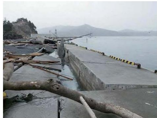
図表 5-13-3 地震と津波によって 崩壊した岸壁(宮城県石巻市)
