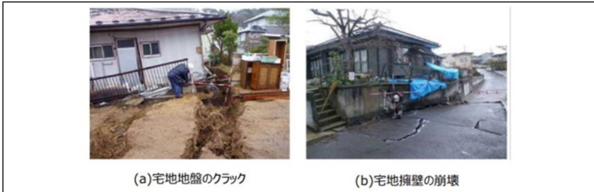
図表 5-4-6 盛土全体とひな壇部分の複合的変形が発生した地区の被害写真
