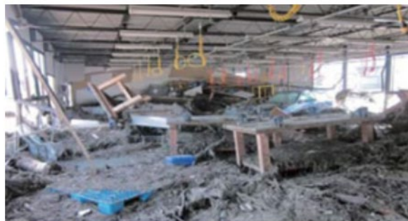
津波により破壊された専修学校の実習室(宮城県岩沼市)
