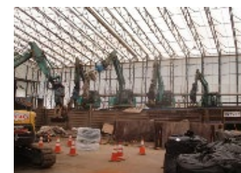
受入・分別施設 施設内(大熊町)
