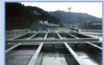
さけ・ます種苗生産施設
