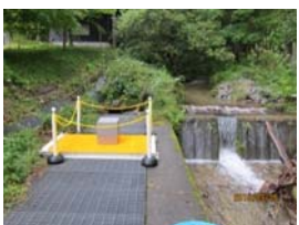
1.2m水車の設置状況(H27.9.24設置)
