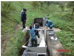
1m水車の設置状況(H27.9.6設置)
