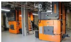
一の瀬地区木質バイオマスのボイラー
