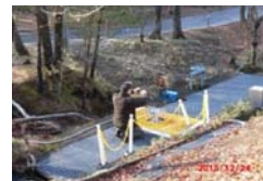
12月24日発電機チェック
