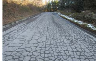
(損壊した道路の路面状況)
