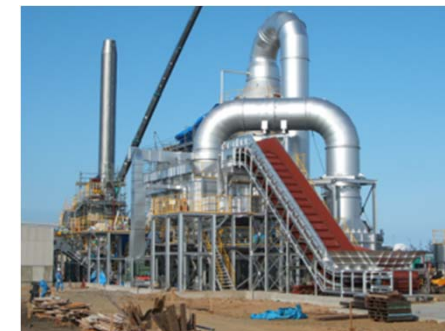
(仙台市設置仮設焼却炉)
