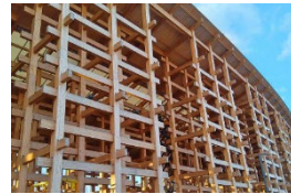
大阪・関西万博大屋根リングでFLAMの集成材が活用
