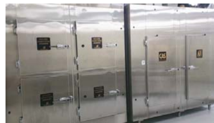
導入されたCASの写真
