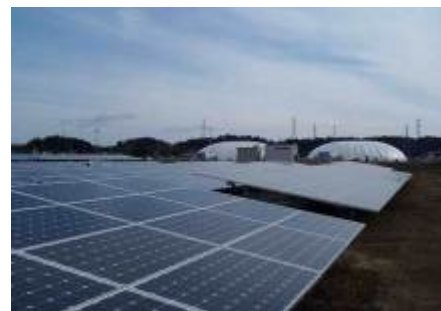
太陽光発電所（平成25年3月）
