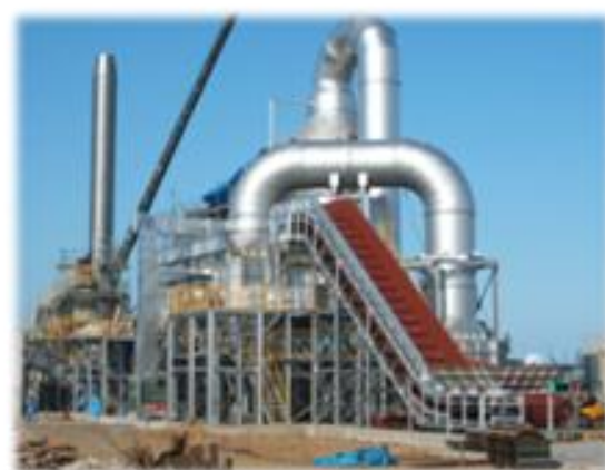
（仙台市設置仮設焼却炉）
