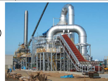
(仙台市設置仮設焼却炉)
