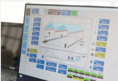
温度や湿度、二酸化炭素の量などを管理しているシステム画面
