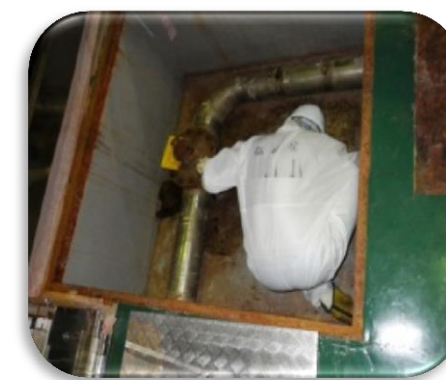
トラブル状況確認
