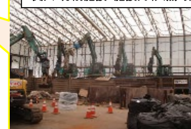
受入・分別施設 施設内(大熊町)
