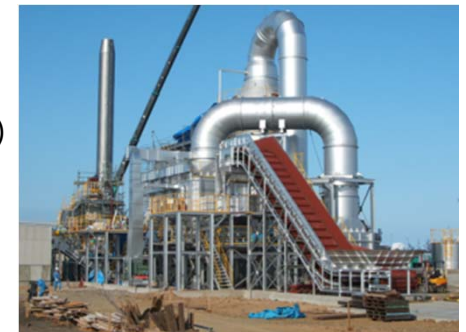
(仙台市設置仮設焼却炉)
